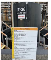
防府工場 アンモニアタンク 掲示物見直し
